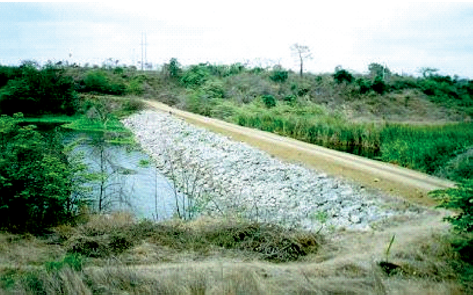
El aliviadero de fusible en la cola del embalse de la Presa Chongón, en la República de Ecuador, fue diseñado y construido en 1993 aplicando el avanzado modelo teórico de erosión gradual desarrollado por el entrevistado para el dimensionamiento seguro de estas peculiares y útiles estructuras.
